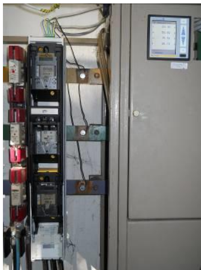
Slika 3: Montaža mernog uređaja - analajzera u postojeći otvor za voltmetar
